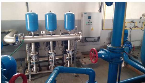
Modernizacja hydroforni w Gizalkach
